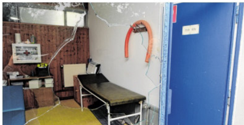
Die Scheibe des Erste-Hilfe-Raums im Voerder Freibad wurde bei dem gestern Früh entdeckten Vorfall eingeschlagen.
