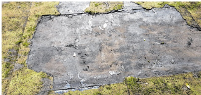
Moos und Flechten hatten sich auf dem Dach breitgemacht.
