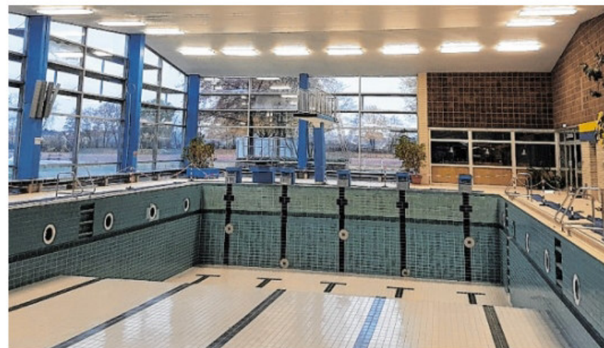
Die Schadstoffbeseitigung im Hallenbad – die Aufnahme ist in der Zeit entstanden, als das Schadstoffkataster erstellt wurde – soll im Februar starten.
